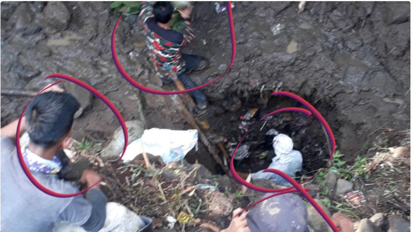
Terlihat tidak satupun para pekerja menggunakan APD di lokasi
